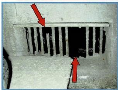
床下通風口の破損
