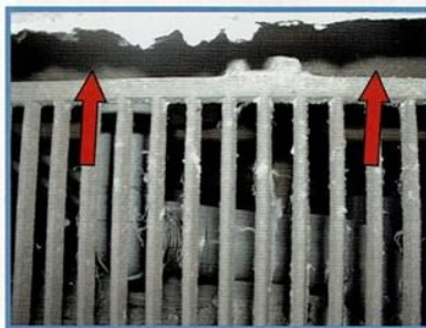
破損はないが上部に隙間がある (鏡を使い下から見る)
