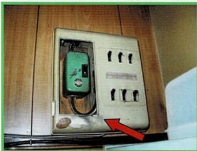
ブレーカー下部から出入していたためカバーが真っ黒
