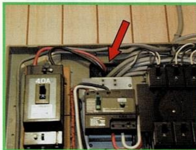
分電盤のカバーをはずすと壁の内部に通じる隙間が見えます
