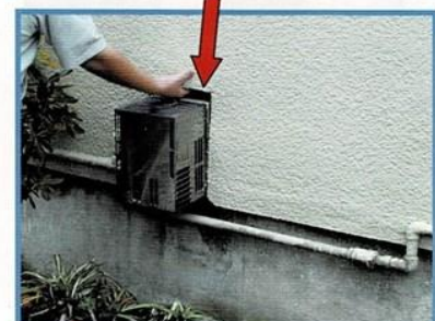
バランス釜排気口の上
