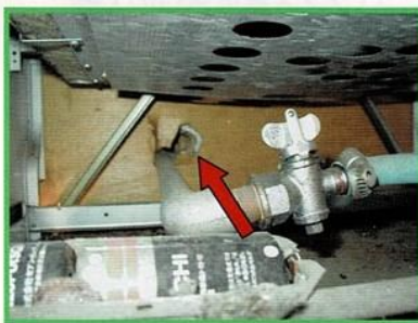
コンバック点検口内部より配管まわりに隙間が
